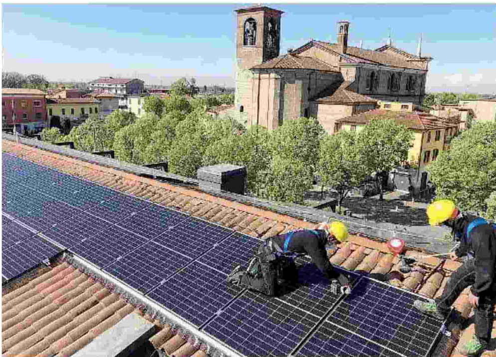
Fotovoltaico. L'impianto installato sul tetto della sede di Ghedi ha permesso di risparmiare 36 ton. di CO2
